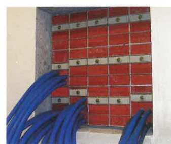
Insgesamt wurden etwa 160 Rahmenschottungen von bst-Döpfl eingebaut. Nur mit dieser Methode kann eine dauerhaft druckdichte Kabeldurchführung hergestellt werden, die auch für Nachinstallationen äußerst flexibel und wartungsfrei ist.
